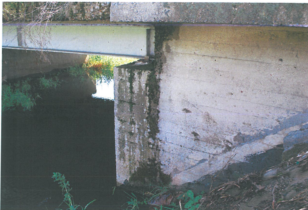
Fot. 21. Wegetacja roślin i zacieki przyczółka świadczące o nieszczelności szczeliny dylatacyjnej – widok od strony północnej.
