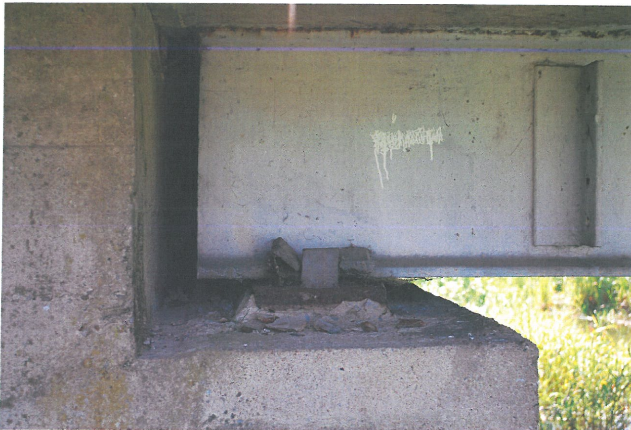
Fot. 19. Zniszczenie zabezpieczeń antykorozyjnych, korozja i zanieczyszczenia łożyska stalowego.
