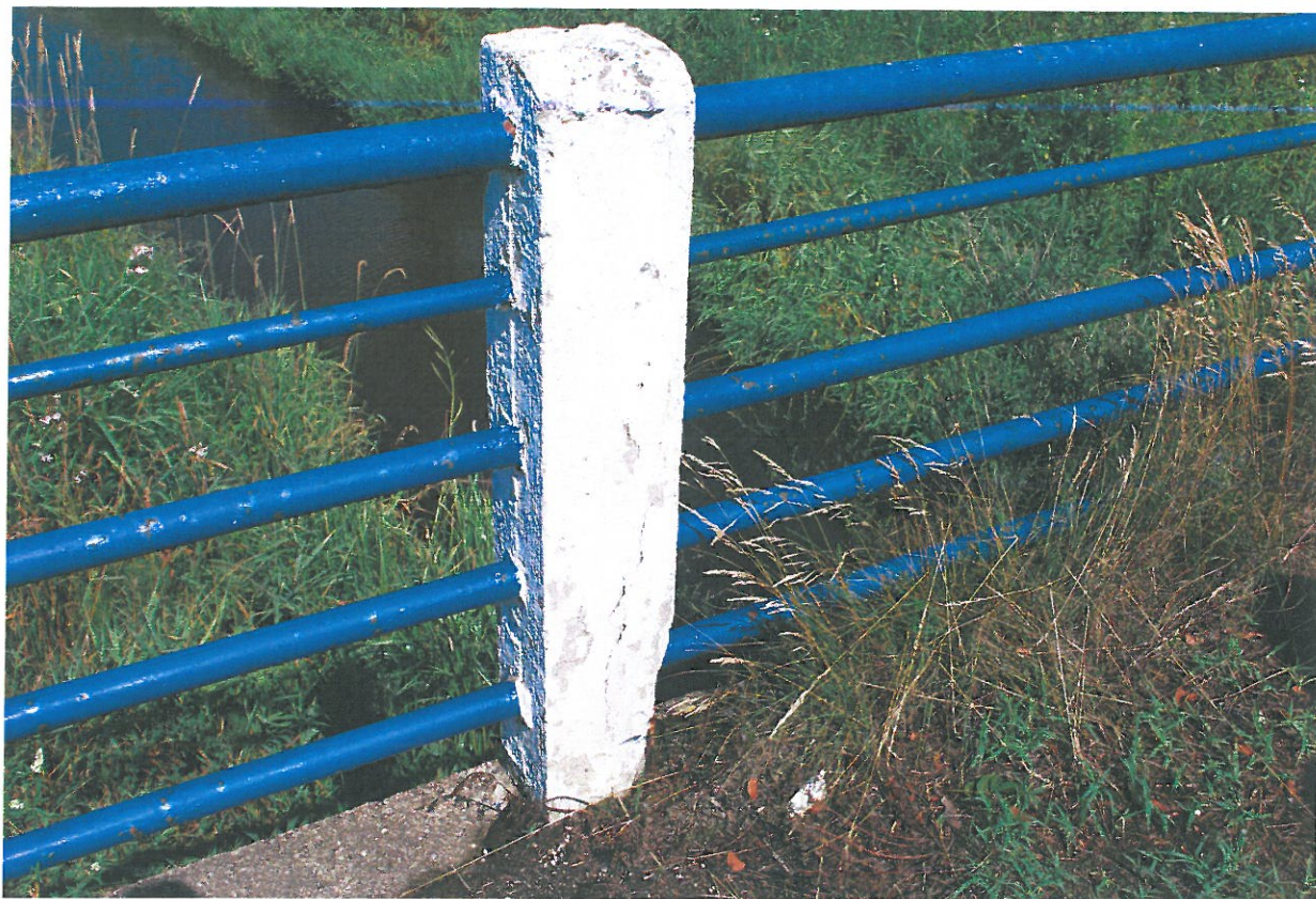
Fot. 11. Zniszczenie zabezpieczeń antykorozyjnych oraz korozja przeciągów i słupków balustrady.
