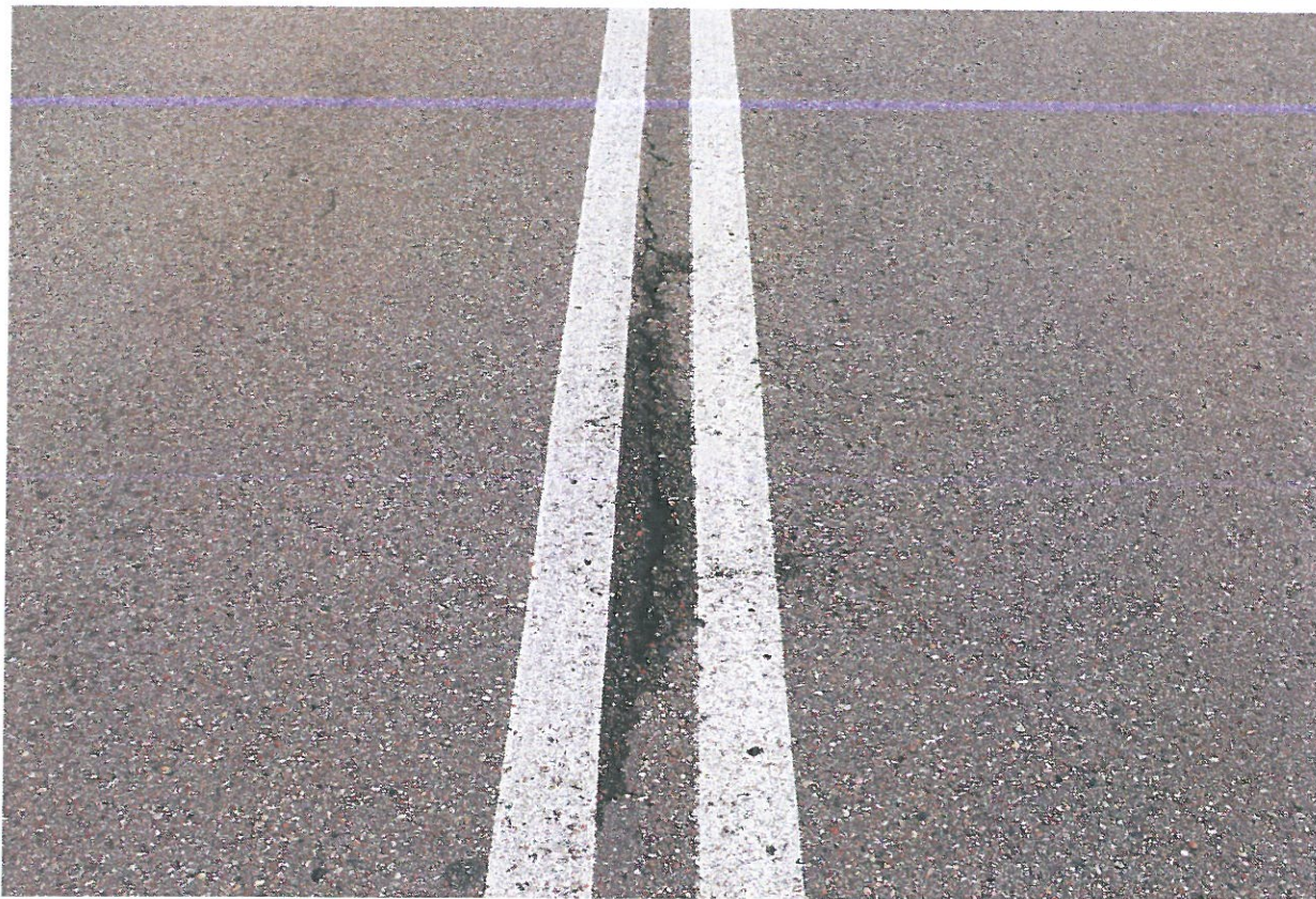
Fot. 7. Rysy i ubytki nawierzchni jezdni na dojeździe od strony południowej.
