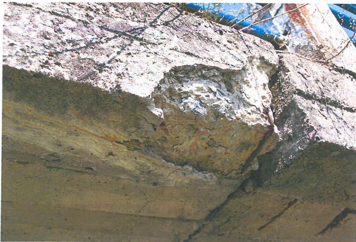
Fot. 15. Ubytki betonu, korozja betonu, korozja odsłoniętych prętów zbrojeniowych płyty pomostu.
