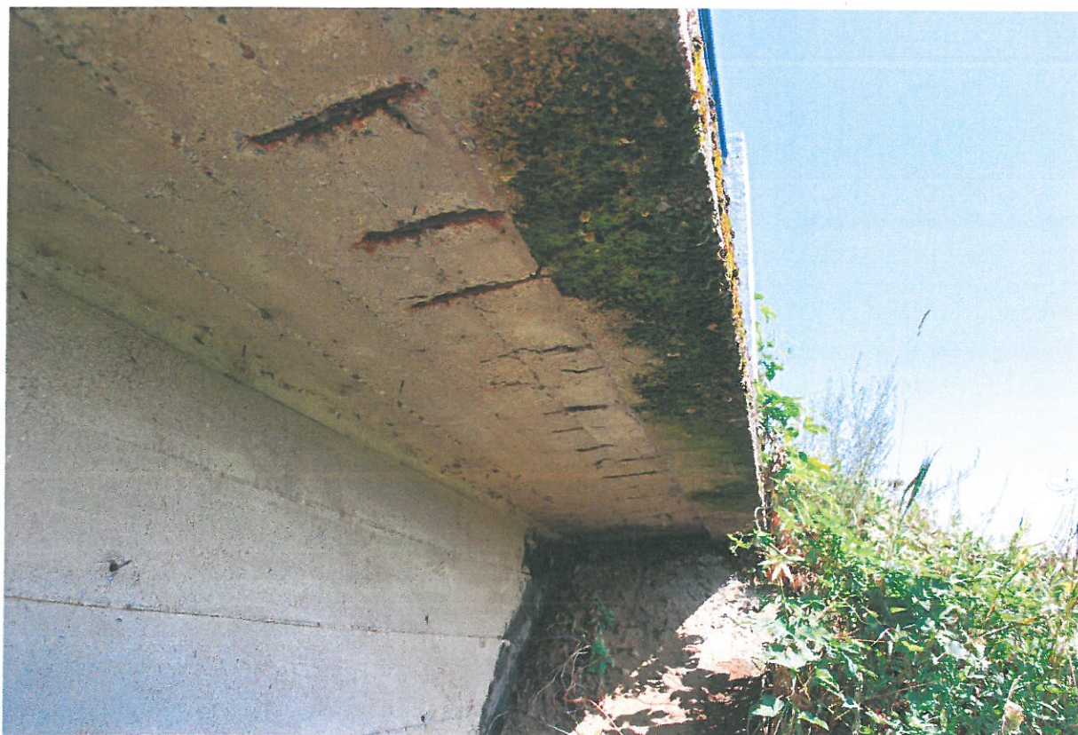
Fot. 22. Ubytki betonu i korozja zbrojenia wspornika skrzydełka przyczółka – widok od strony północnej.
