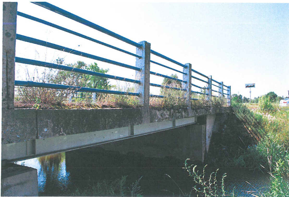
Fot. 13. Wegetacja roślin, zanieczyszczenia, ubytki betonu i korozja zbrojenia gżysmu – widok od strony dolnej wody.
