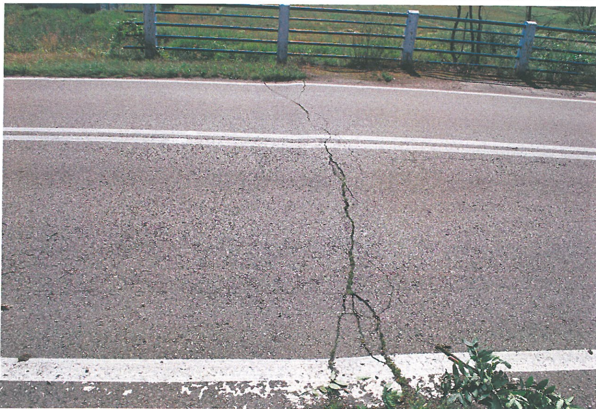
Fot. 8. Rysy, ubytki, deformacje nawierzchni jezdni - widok od strony północnej.
