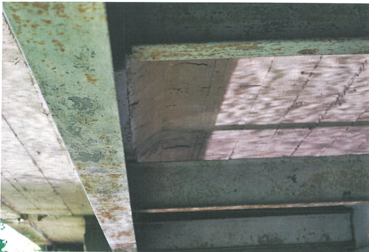
Fot. 18. Zniszczenie zabezpieczeń antykorozyjnych, korozja i zanieczyszczenia konstrukcji stalowej mostu.
