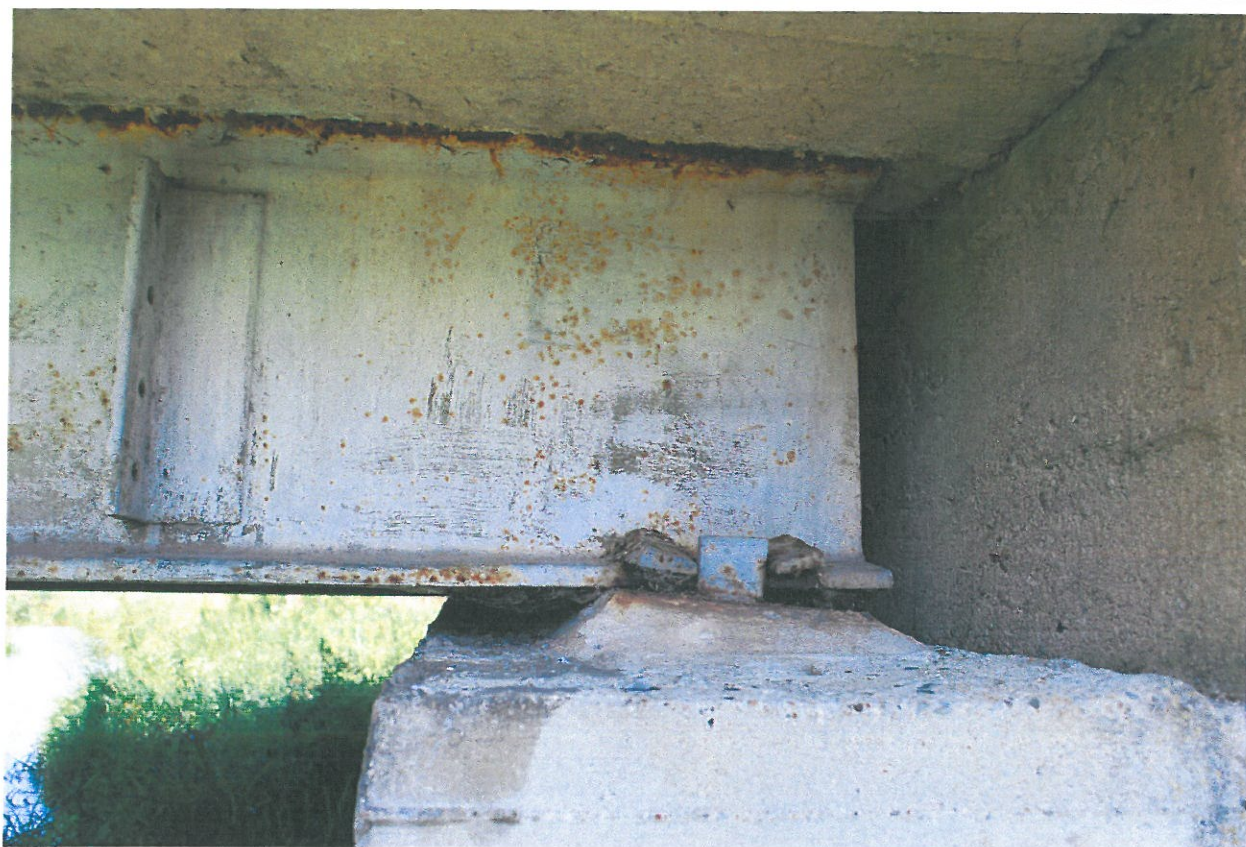
Fot. 20. Zniszczenie zabezpieczeń antykorozyjnych łożyska stalowego.
