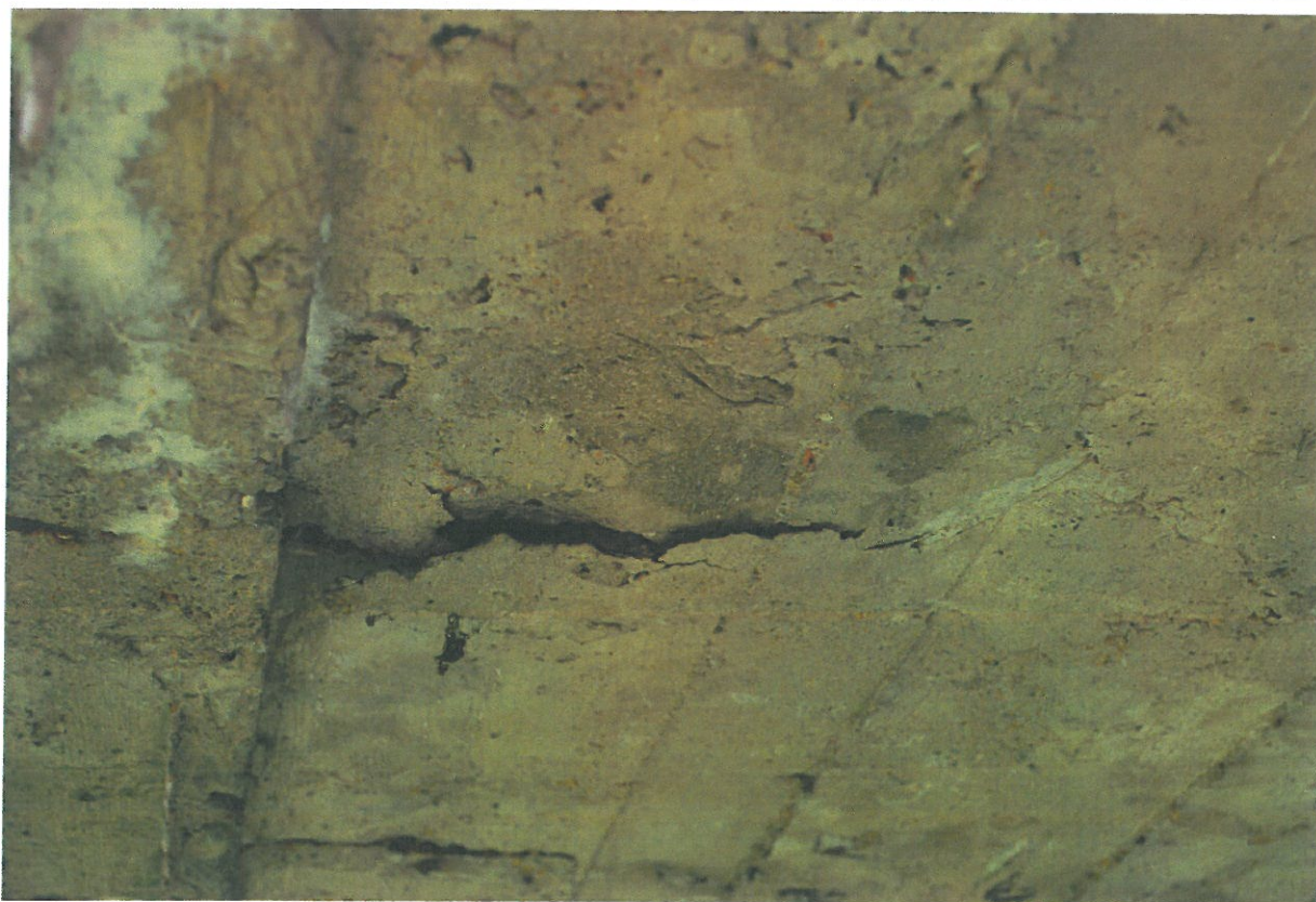
Fot. 16. Ubytki betonu, zacieki i wykwyty świadczące o braku skuteczności izolacji płyty pomostu.
