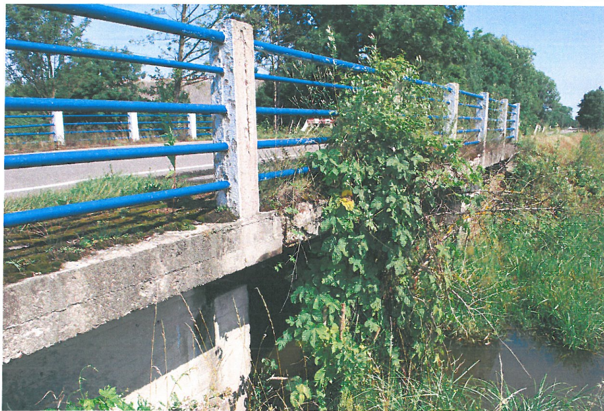
Fot. 14. Wegetacja roślin, zanieczyszczenia, ubytki betonu i korozja zbrojenia gżysmu – widok od strony górnej wody.
