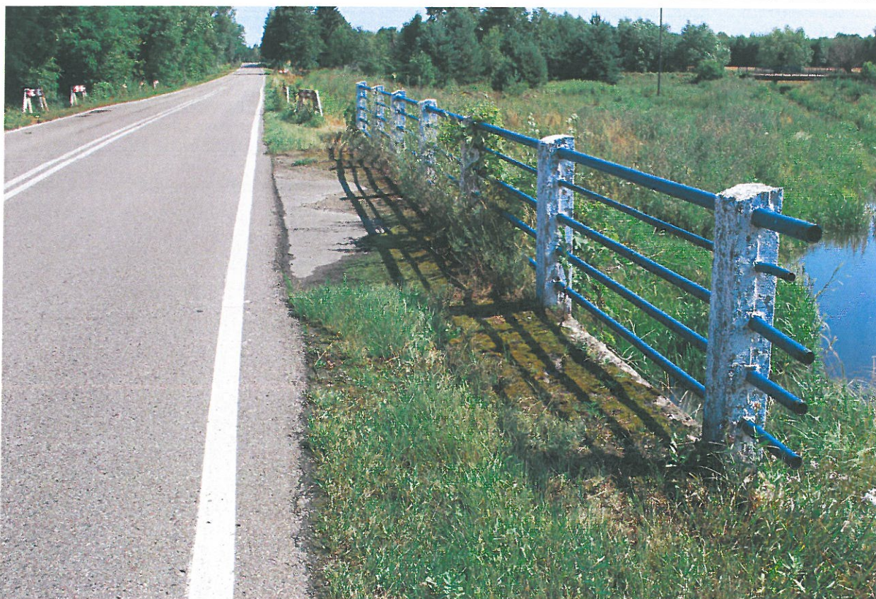
Fot. 10. Zanieczyszczenia, rysy, ubytki, deformacje nawierzchni chodnika – widok od strony górnej wody
