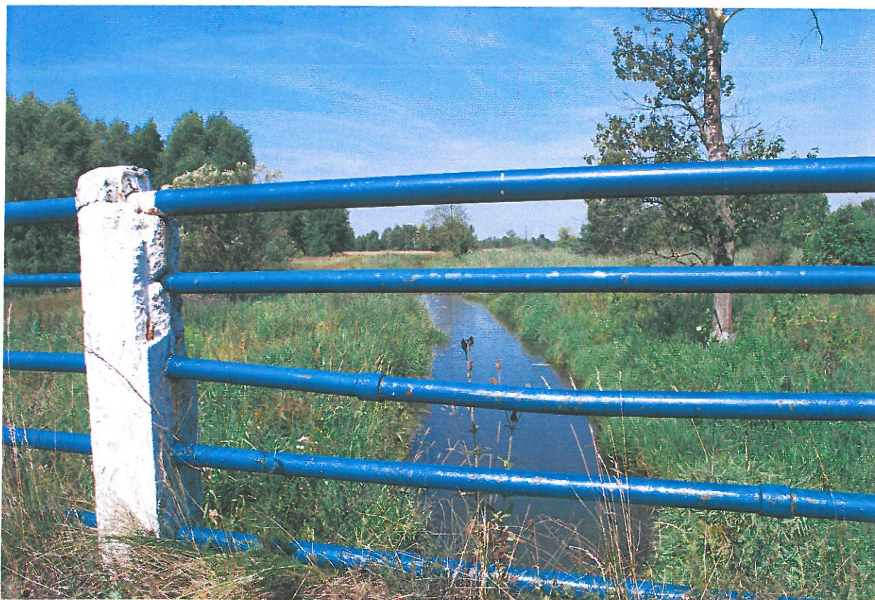
Fot. 12. Ubytki betonu słupka balustrady. Deformacja przeciągu balustrady .
