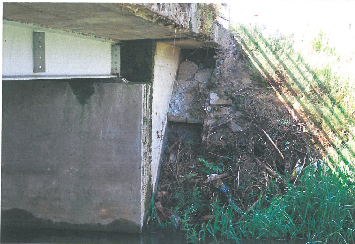
Fot. 6. Wegetacja roślin, zanieczyszczenia oraz ubytki wzmocnienia stożka od strony południowej – widok od strony dolnej wody.
