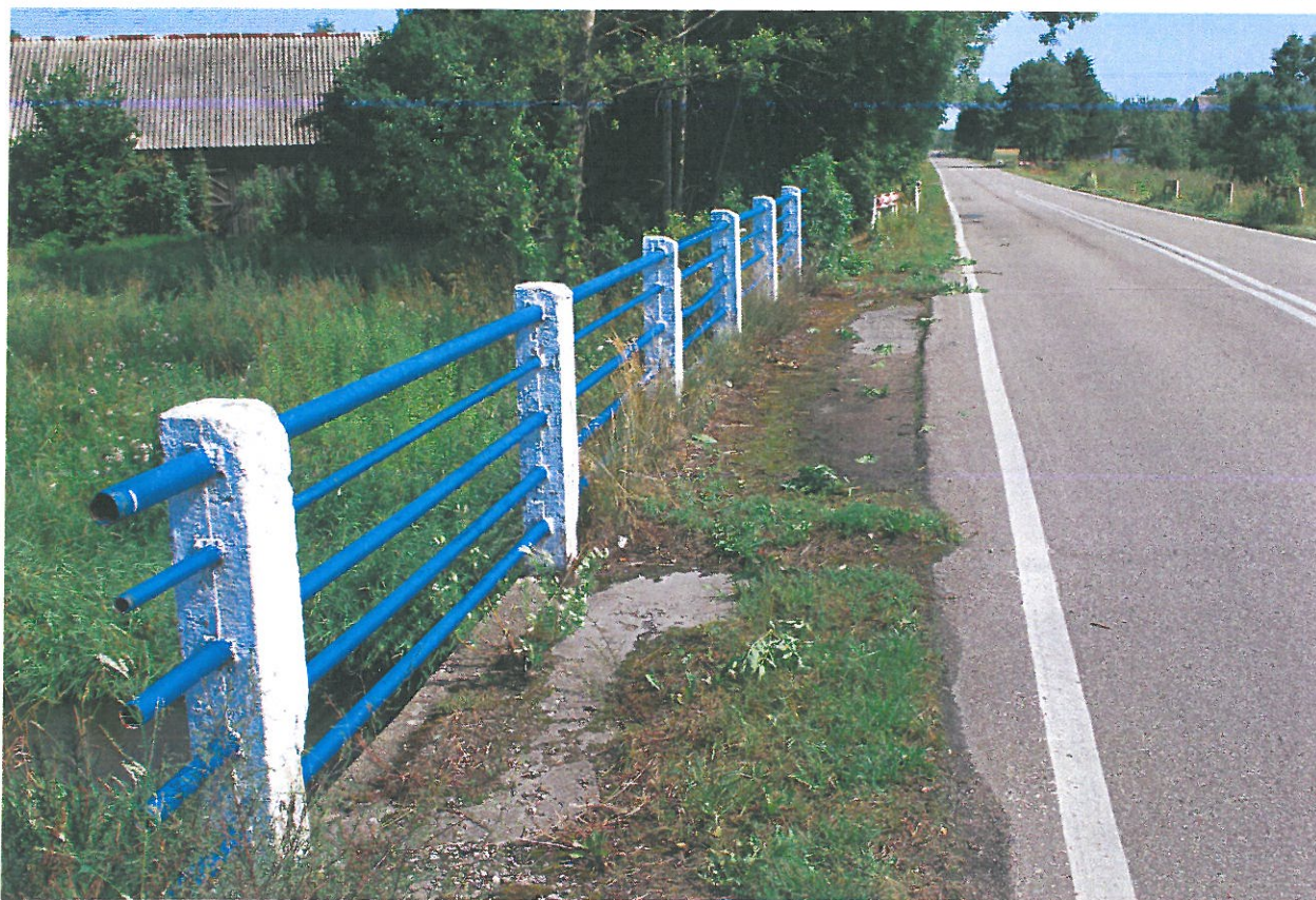
Fot. 9. Zanieczyszczenia, rysy, ubytki, deformacje nawierzchni chodnika – widok od strony dolnej wody
